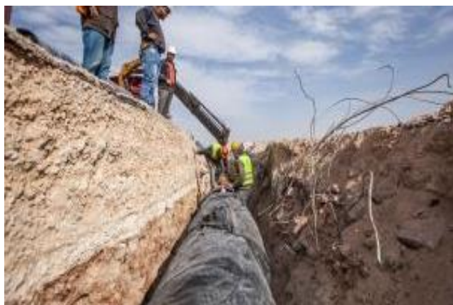
Fig. n° 8 canalisation de transfert des eaux AEP
