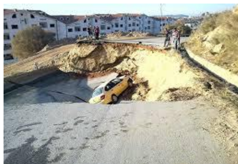
Fig. n° 2 effondrement de la route menant à sidi aissa
