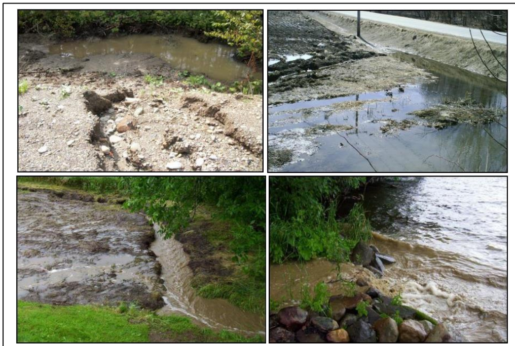
Erosion, sédimentation et inondation
